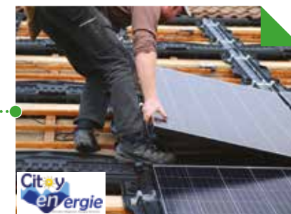
→ Création de Citoynergie : CCAS, CCG puis Chablais et CCPR. Pose de panneaux photovoltaïques à Reignier.
